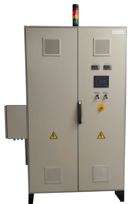
Laboratorio de Ensayo de Potencia hasta 80kW continuos
